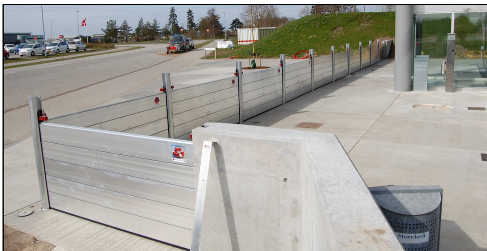
Storebælt AC er sikret mod oversvømmelse med en PREFA® Vandbarriere, der - for at tilpasse sig forpladsens og terrænets udformning - er udført med en 90° vinkel
