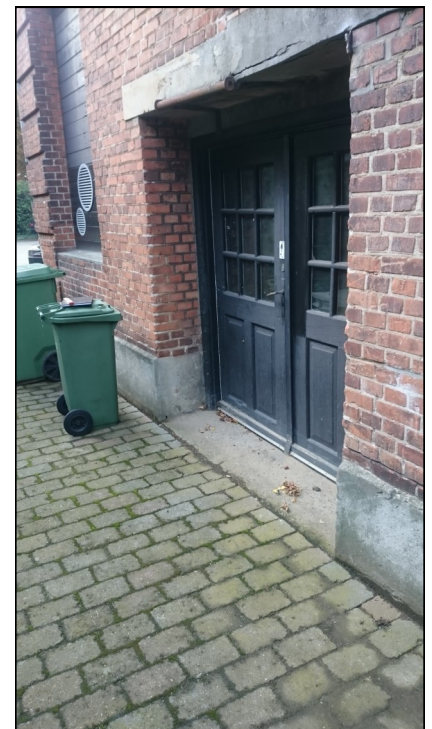
Det udsatte dørparti på bygningens bagside er placeret på matriklens absolut laveste punkt. På dette sted er der helt niveaufri adgang mellem det omgivende terræn og gulvet i underetagen.
