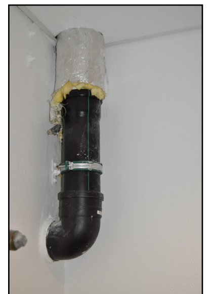
Et af de to indvendige tagedløb der bristede under skybruddet i august 2020. Nedløbene er nu sikrede med en montagebøjle, der er fastgjort til væggen.
